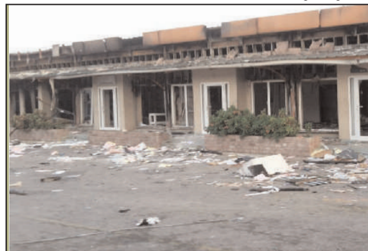
Un complexe commercial pillé complètement.
